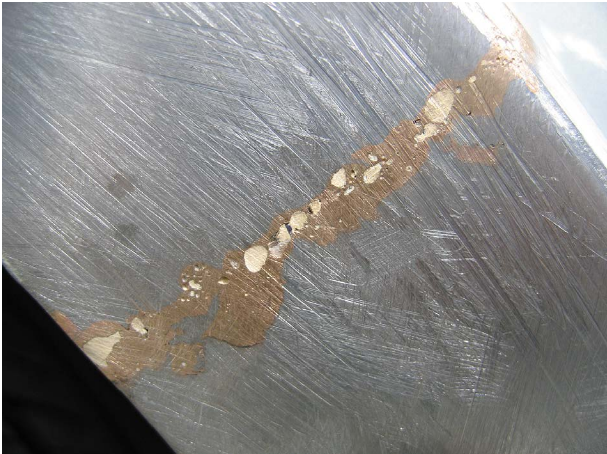
Mangelhafter Ersatz einer Seitenwand mit nicht freigegebener und unfachmännischer MIG-Lötung bei einem 4-jährigen Renault Scénic (Bild Flückiger)
